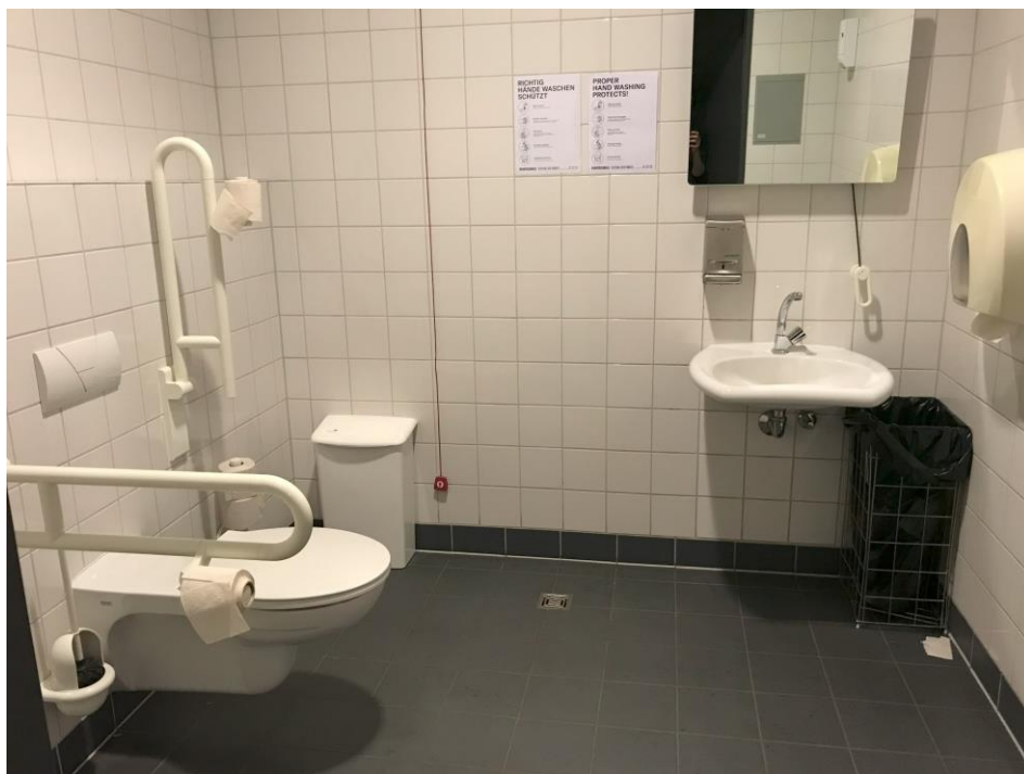
6 Rollstuhlgerechtes WC im Salzlager
